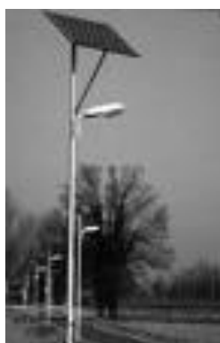
Foto 5 palo di illuminazione stradale alimentato con pannello fotovoltaico
